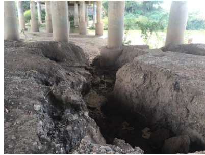
Figura 88 Erosión del suelo
