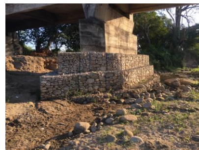
Figura 40 Socavación en pila
