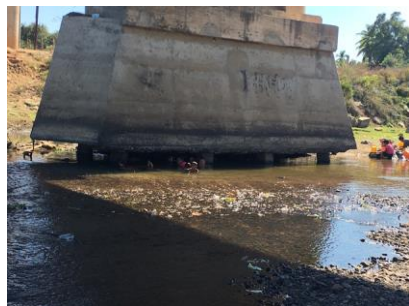
Figura 47 Socavación en pila de puente
