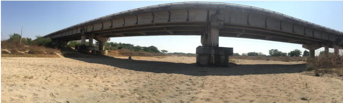
Figura 43 Vista del puente y socavación
