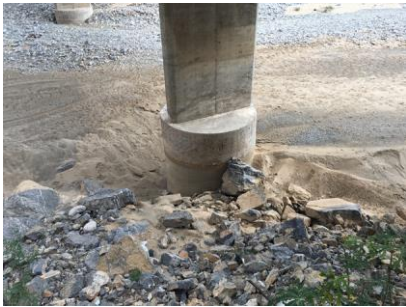
Figura 72 Socavación en pila
