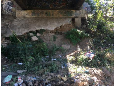
Figura 52 Daños a cono de derrame
