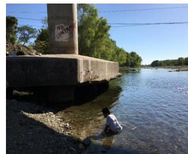
Figura 24 Socavación en pila
