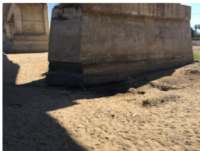
Figura 46 Altura de socavación
