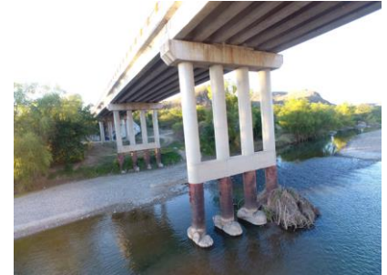
Figura 64 Socavación de pilas de puente
