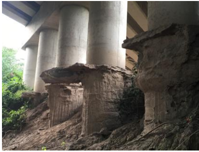
Figura 56 Socavación de pilas
