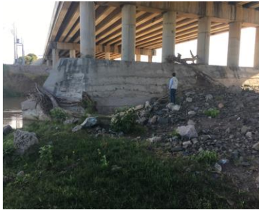
Figura 59 Socavación en pila de puente
