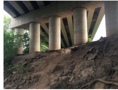
Figura 55 Socavación de pilas
