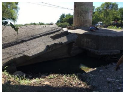
Figura 23 Evidencia de colapso de puente anterior
