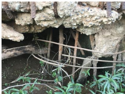
Figura 34 Estado de deterioro de pilotes
