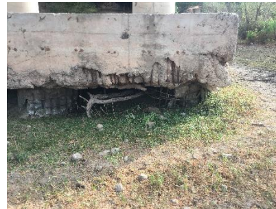
Figura 35 Daño en pilotes
