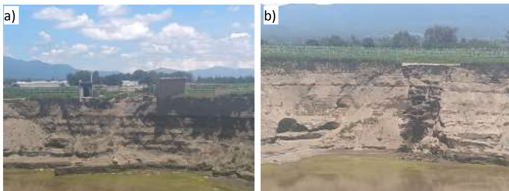
Fig. 3. Vistas de las paredes que delimitan la periferia del socavón
