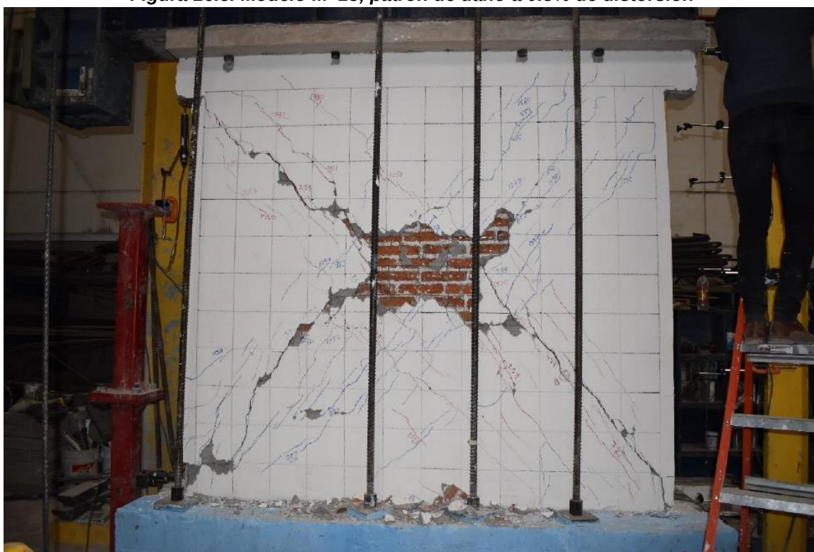
Figura 16.f. Modelo M-13R, patrón de daño a 1.0% de distorsión
