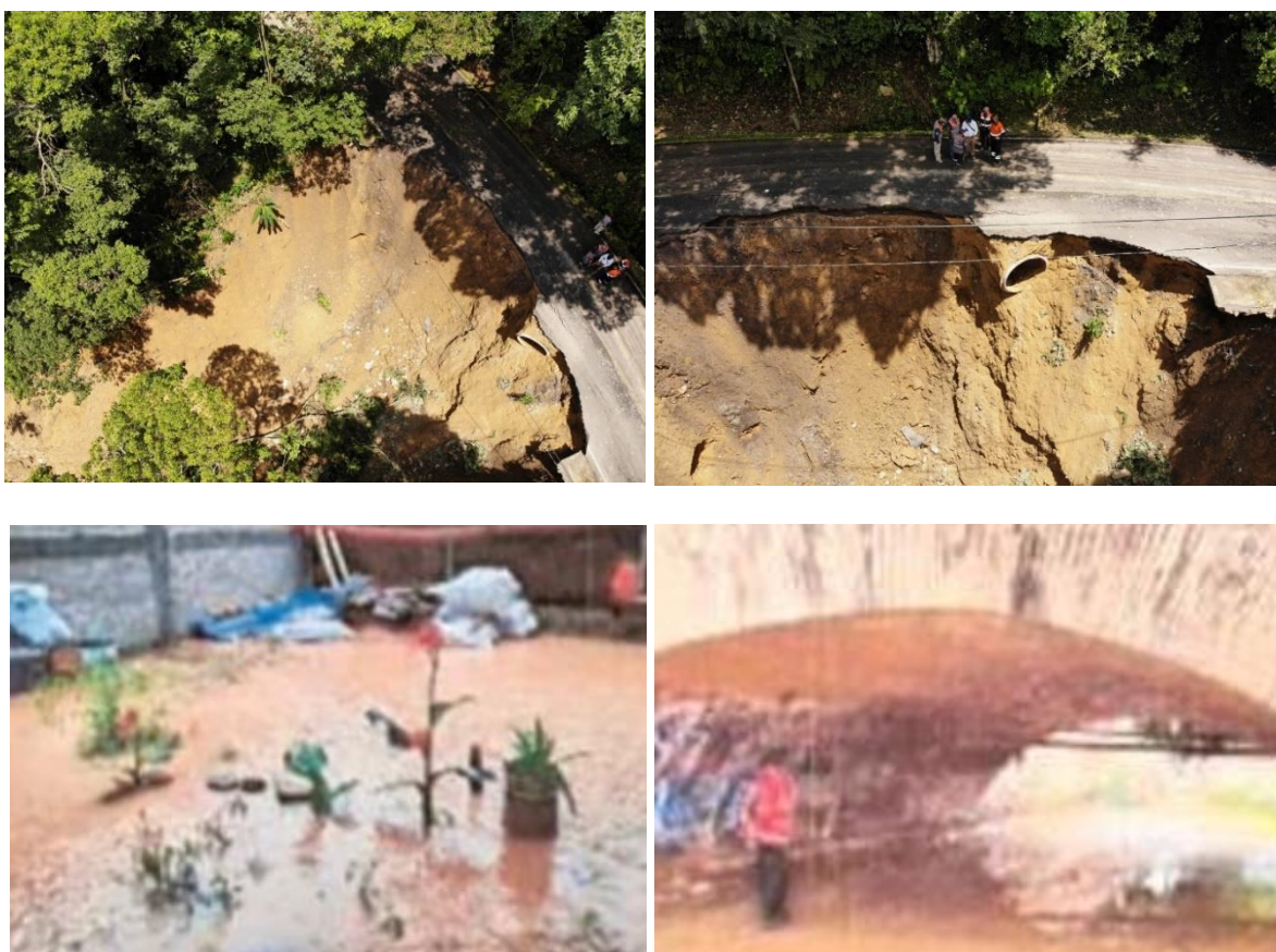
Fig. 5. Imágenes donde se muestra la tubería la cual se considera como actividad antrópica
