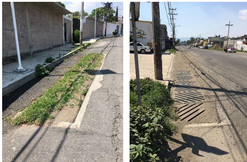
Figura 4.5 Azolvamiento en bocas de tormenta ubicadas en Monte Carmelo, imagen de la izquierda ubicada en zona alta e imagen derecha en zona baja
