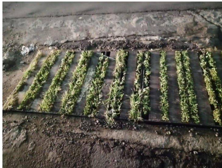
Figura 4.71 Coladera de piso longitudinal sin capacidad de captación
