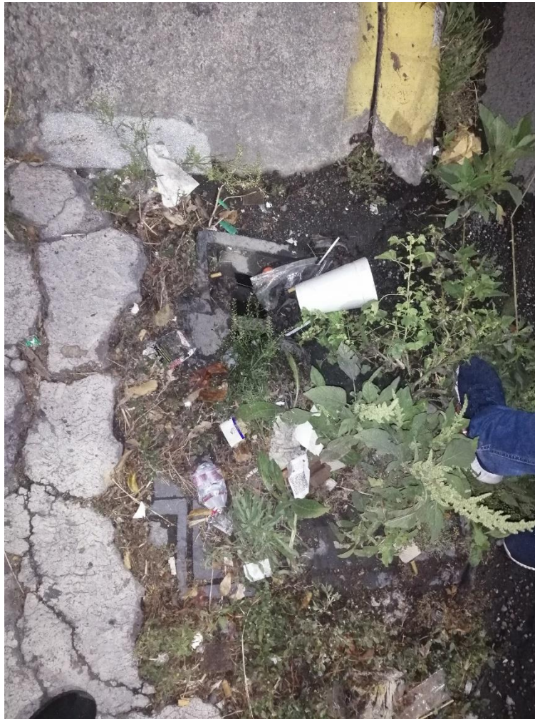
Figura 4.73 Coladera de piso núm. 3, totalmente obstruida por basura y vegetación
