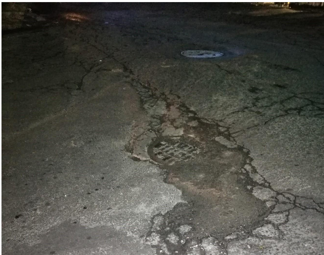
Figura 4.76 Pozos de visitas sobre la vía camino a San Lorenzo
