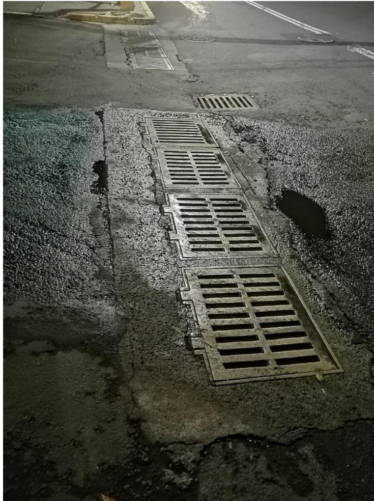
Figura 4.69 Coladera de piso (núm. 2) en posición transversal al flujo
