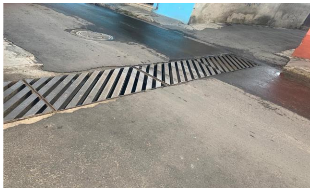
Figura 4.33 Boca de tormenta, identificada como punto crítico de inundación, ubicada en la calle Camino Nacional, San Lucas Xochimanca, Xochimilco
