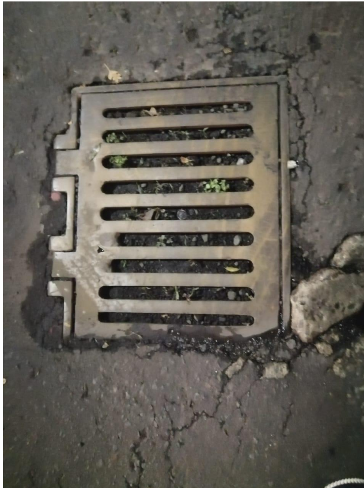
Figura 4.70 Coladera de piso rejilla azolvada
