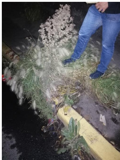
Figura 4.75 Obstrucción en coladera de banquetta núm.3 (Fuente: SRI, 2020)
