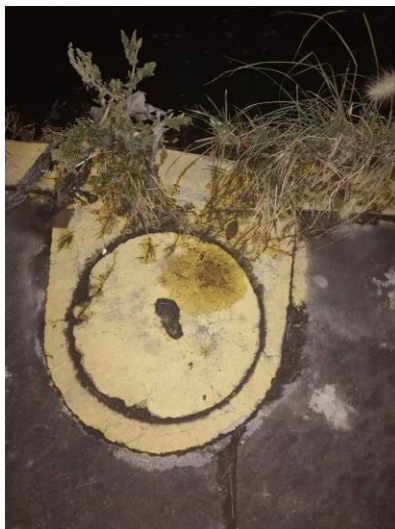
Figura 4.74 Coladera de banquetta núm.1 con presencia de vegetación (Fuente: SRI, 2020)
