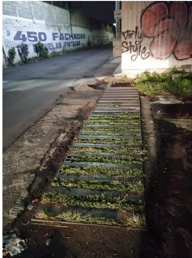
Figura 4.72 Coladera de piso (núm. 1) en posición longitudinal, obstruida por vegetación
